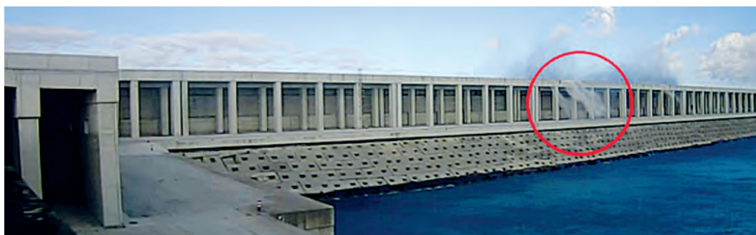
Fig. 6. Evento clasificado como no peligroso asociado a un falso negativo registrado en la 3ª alineación del dique.
