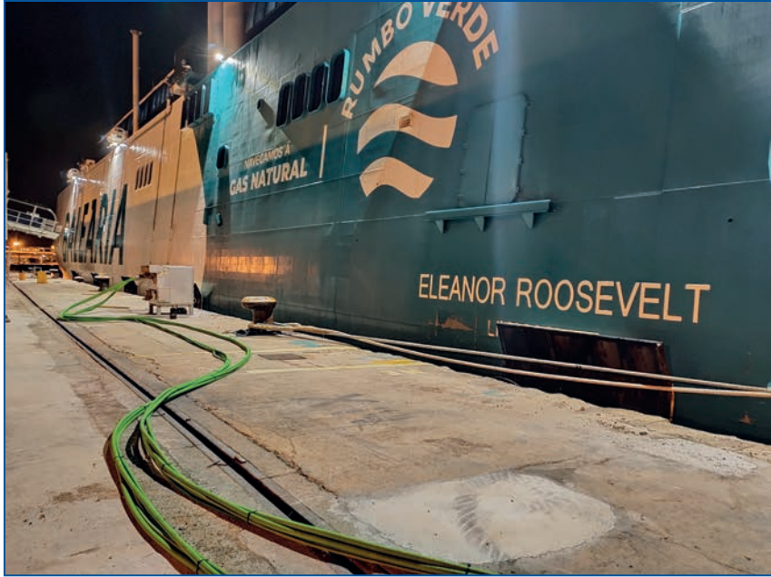
Fig. 6. Inauguración punto de conexión baja tensión (diciembre 2021).
