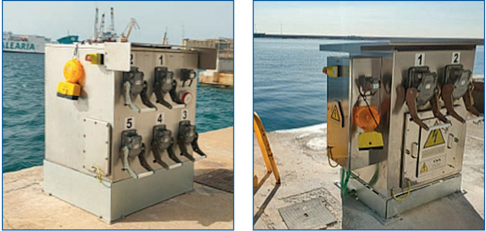
Fig. 3. Cajas de conexión para BT y para MT.
