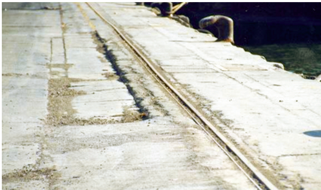
Fisuración de pavimento.
