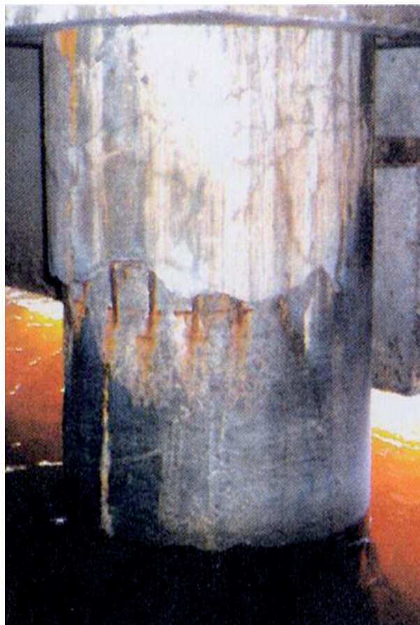
Corrosión de armadura de un pilote.
