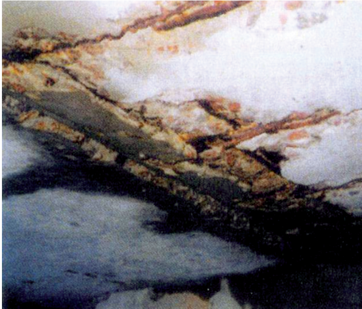
Corrosión de armadura de una losa superior en muelle.
