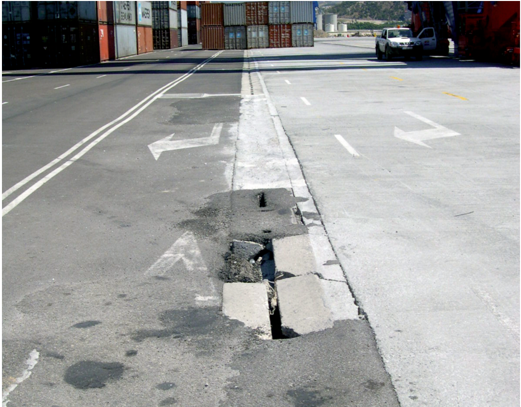
Rotura de un elemento de drenaje.
