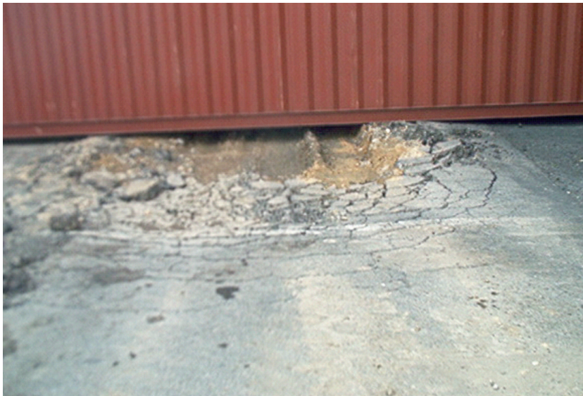
Ejemplos de daños un pavimento que condiciona su utilización con alguna restricción (calificación: 2)
