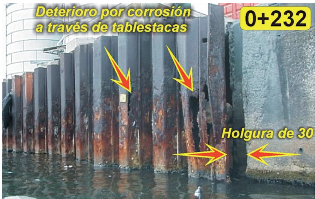
Corrosión de tablestacas.
