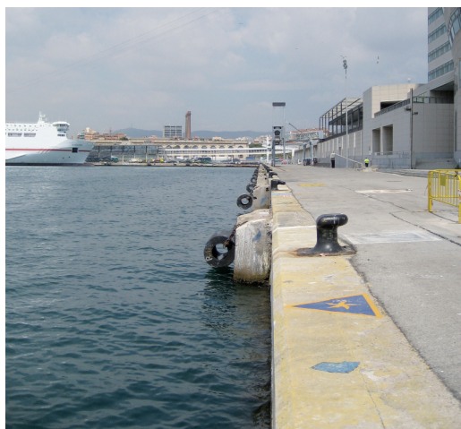
Desalineación de un muelle de bloques.
