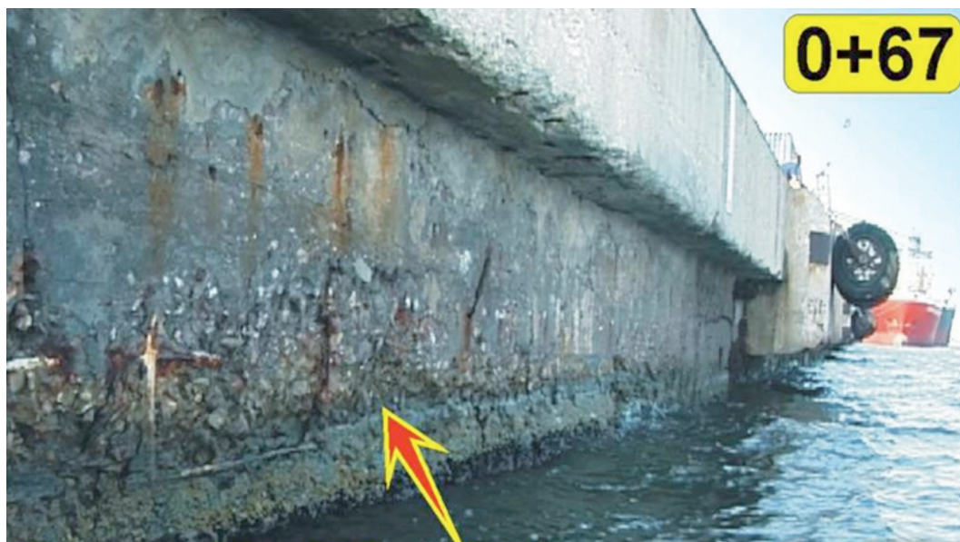
Corrosión de la armadura del cajón.
