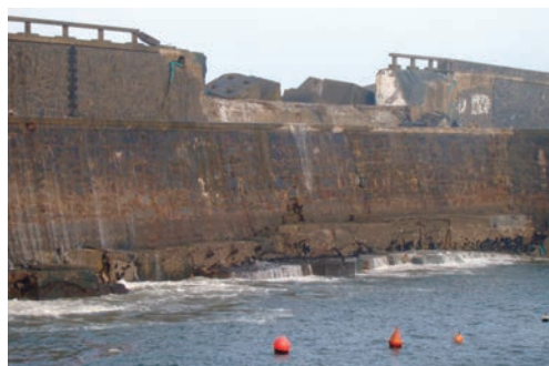
Rotura del espaldón, temporal 09.02.2016.
