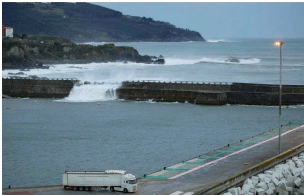
Rotura del espaldón durante el temporal del 9 de febrero de 2016.
