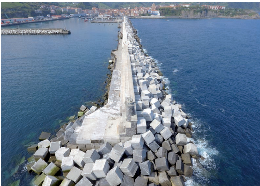
Vista general del refuerzo del dique de Bermeo (foto tomada desde vuelo dron).
