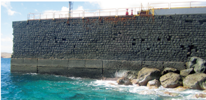
Figura 7. Déficit de escollera en el tramo final del frente expuesto.
