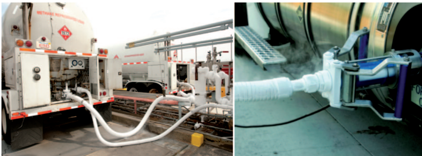
Sistema de carga de camiones cisterna TTS.
