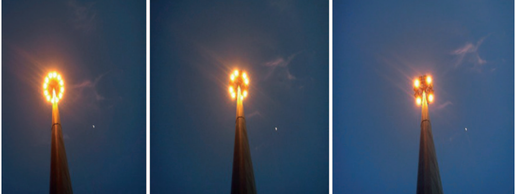
Figura 4. Modos de funcionamiento de la torres de alumbrado: 100% - 66% - 33% (Fuente: Autoridad Portuaria de Alicante).
