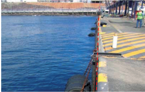
Figura 5. Desalineación en el frente.
