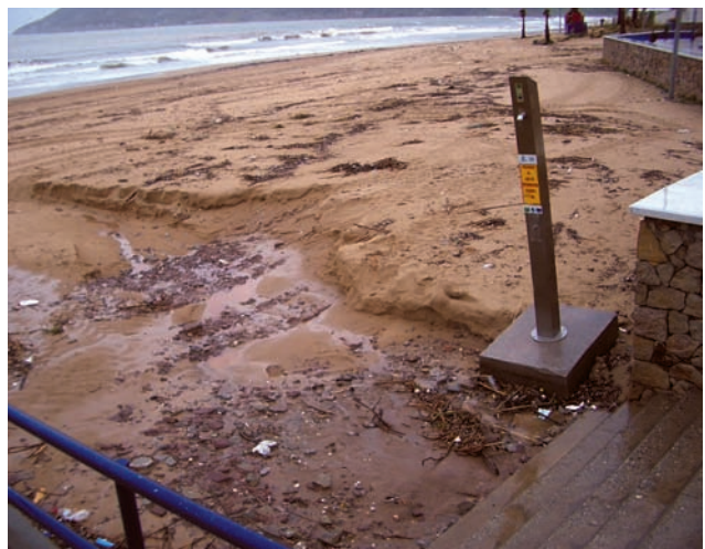
Figura 31. Erosiones causadas por pluviales, vertiendo con fuerza, directamente sobre la playa.
