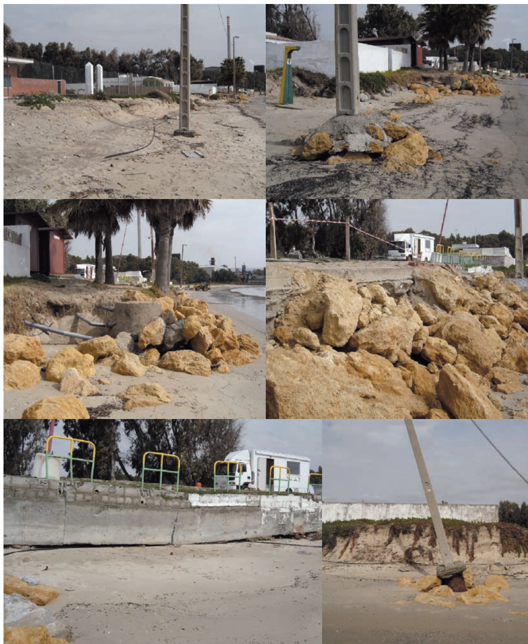
Figura 22. Zona norte de la playa de Palmones, en donde se producen habitualmente las mayores erosiones.
