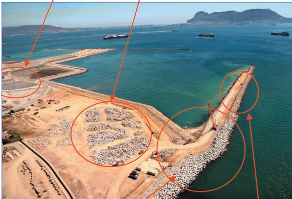
Manto principal de piezas especiales
