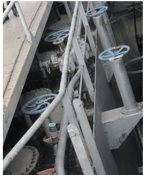
Figura 5. Detalle armado de puertas. Valvulería.
