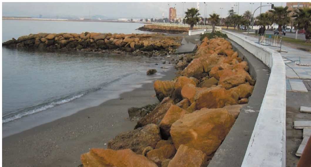
Figura 29. Falta de playa seca extremo norte y afección al paseo marítimo con temporales.
